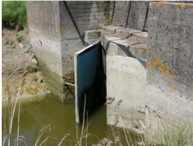
Une porte à flot à marée descendante
