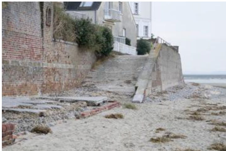
L'érosion côtière affecte également les constructions du bord de mer (Le Crotoy, Somme, France)
