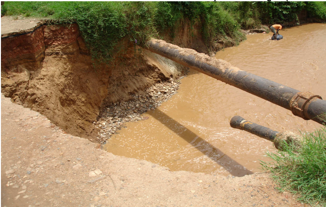
Photo. n°16 : Destructions des infrastructures routières par la Ntakangwa (février 2008)
