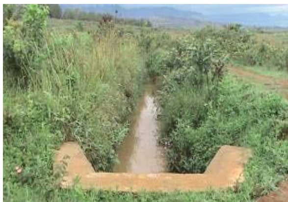
Figure 104 : Canal principal dans le périmètre de Rukoziri (non-revêtement et pauvrement entretenu) (source : FAO)
