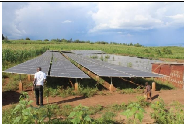
Figure 24: Vue du champ photovoltaïque au bord du lac Rweru
