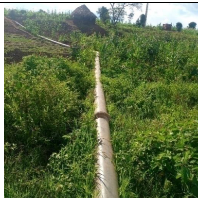
Figure 25: Conduite de refoulement de l'eau pompée vers une citerne située dans la réserve de Murehe
