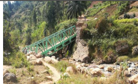
Figure 19: Pont reliant la zone Kanyosha à la zone Kiyenzi détruit suite à l'érosion latérale des berges de la rivière Kanyosha (2023)
