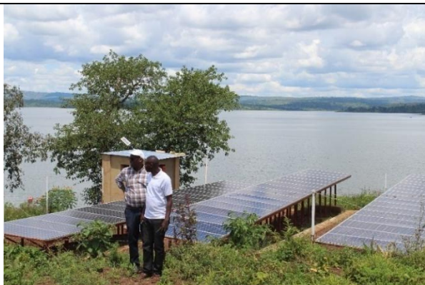
Figure 21: Panneaux solaires pour le pompage de l'eau d'irrigation
